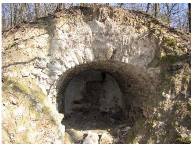
Befalazott és nyitott, de félig beomlott táró
