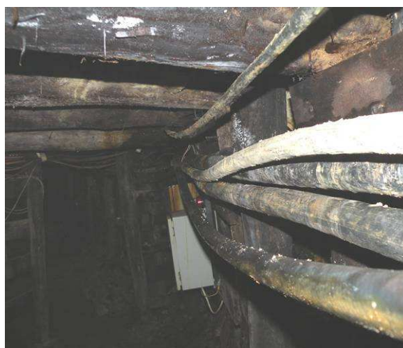
Tápkábelek húzódnak az Altáró falán, még most is szolgálják az áramellátást
